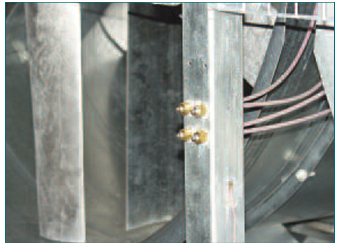
Figura 2B. Conexões e tubos de Nylon da linha SLM para lubrificação
